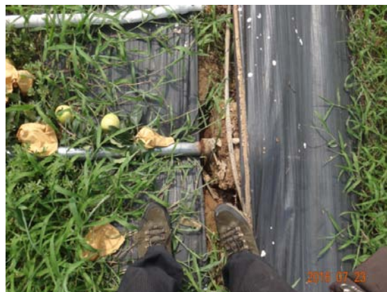
图 14-2 起支撑作用的钢管所埋深度不够
